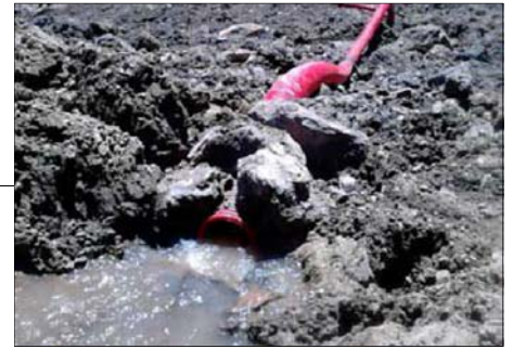
DRENAJE. Una tubería se encarga de sacar el agua que se acumula en el argayo para frenar el deslizamiento.
