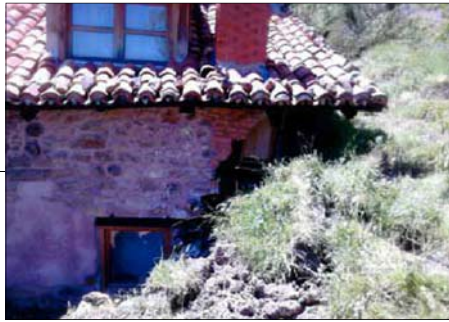
DESTROZO. La vivienda de Sebrango afectada por el argayo presenta serios daños estructurales. / REDONDO
