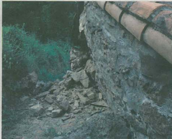
Los daños en algunas viviendas son ya evidentes. :: P. A.
